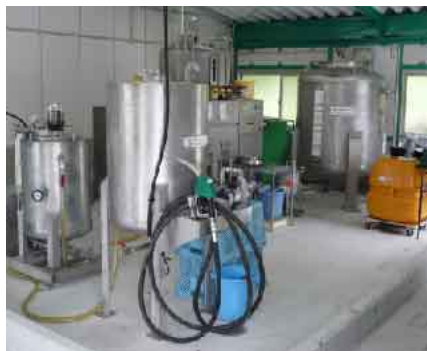
「岩屋エコプラザ」のBDF精製設備
