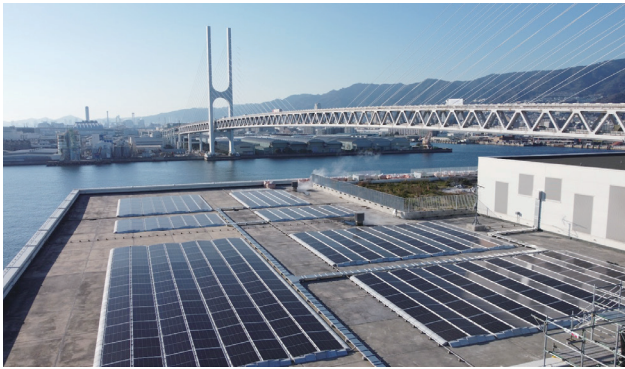
▲工場屋上に設置した太陽光パネル
