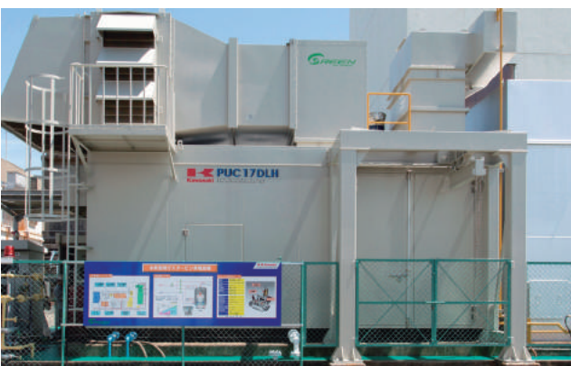
▲写真4 低NO x 水素混焼ガスタービン発電設備
