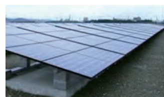
▲太陽光発電施設の設置例
